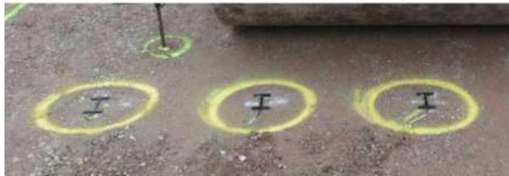
Fot. 2 Czujniki odkształceń (ASG) na warstwie podbudowy z kruszywa łamanego stabilizowanego mechanicznie
